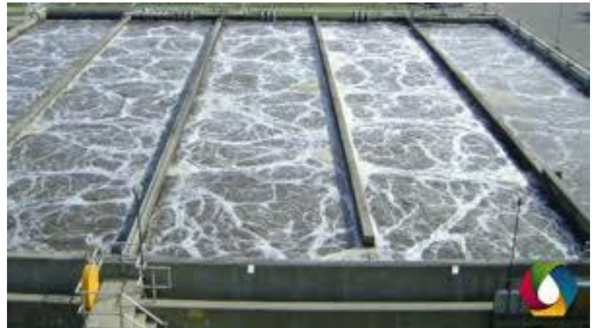
Tanque de aireación
